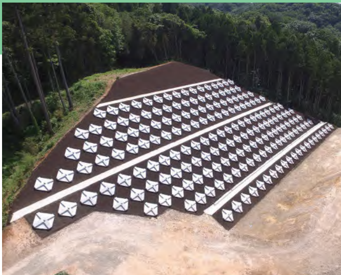
PCフレーム:TSS250-45(島根県大田市)
