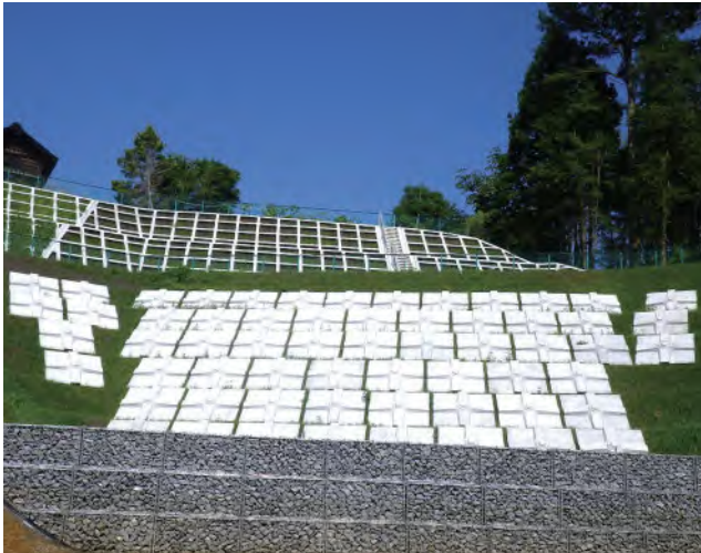
PCフレーム:HS250-30(栃木県高根沢町)
